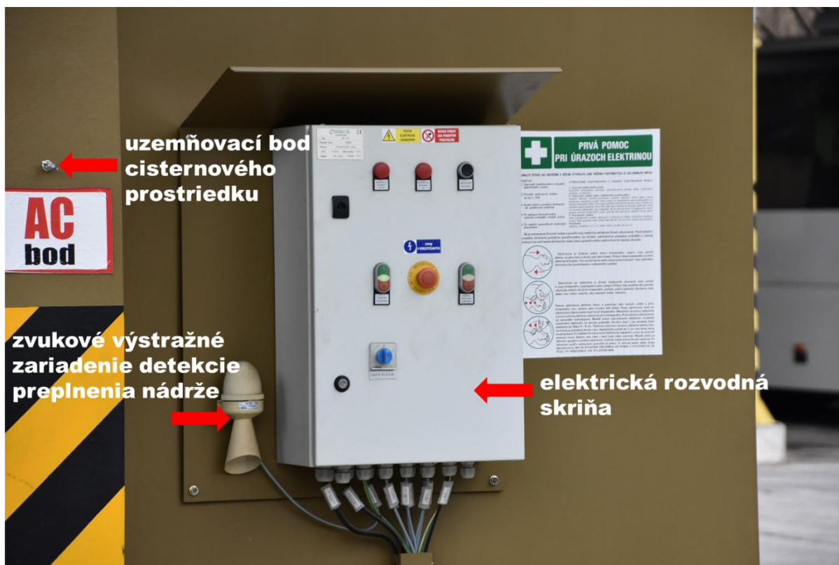
Obrázok č. 10. Detail elektrickej rozvodnej skrine.
